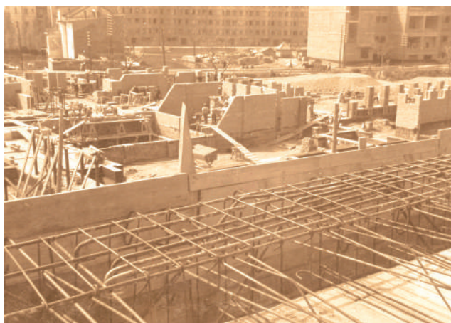
1937, Нови Сад. Фотографија настала током подизања еркерне конструкције између приземља и првог спрата Административне зграде Банске палате
