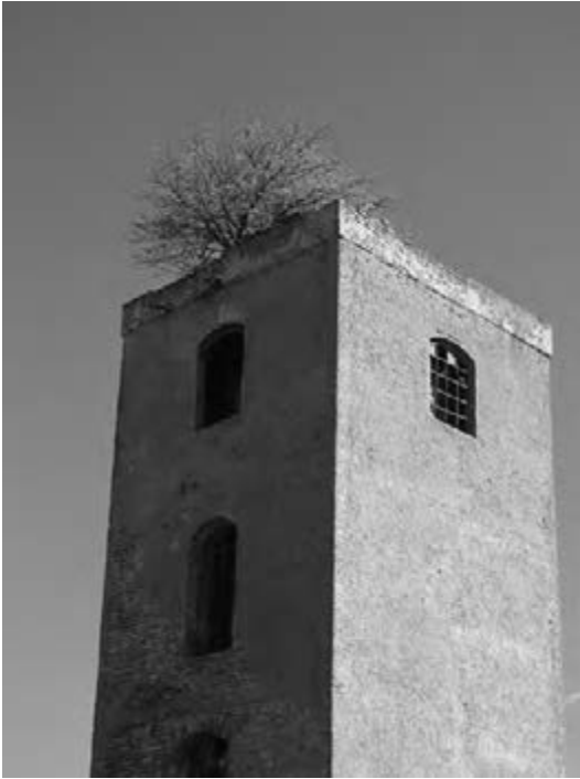
Дрво на крову железничког водоторња у Инђији Фото: Жељко Марковић
